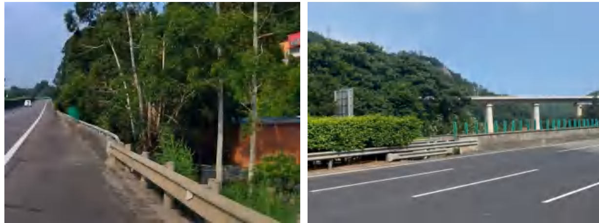
图3-5 混凝土护栏与钢护栏搭接现状
