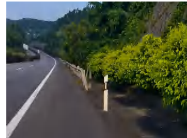
图3-3 K2076+319~K2100+322段路侧钢护栏端部现状
